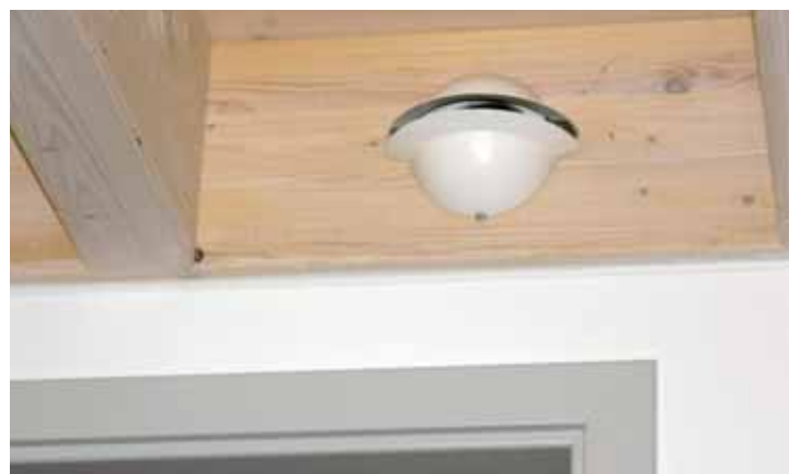
Slika 129: Vpihovalna šoba za dovodni zrak na steni (levo); vpihovalna šoba na steni nad vrati usmerja dovodni zrak globoko v prostor in preprečuje, da bi se spustil ob vratih in odtekel skozi režo pod njimi.
